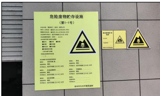
贮存设施外部警示标志牌
