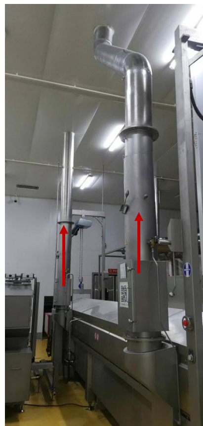
油炸机及油烟管道
